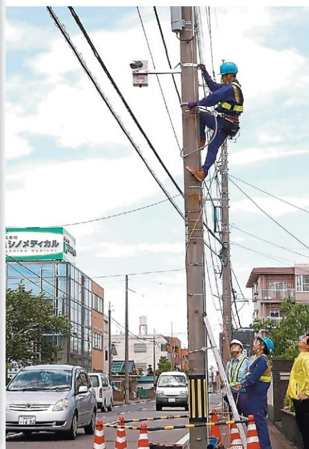
電柱に設置された 防犯カメラ
